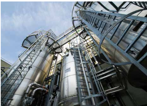
Die bioliq®-Pilotanlage vereinigt vier Verfahrensschritte: Schnellpyrolyse, Hochdruck-Flugstromvergaser, Gasreinigung und Kraftstoffsynthese
