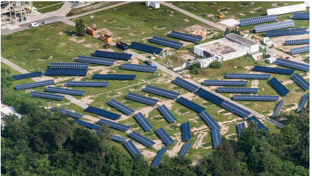
Mit dem Solarstrom-Speicherpark am Campus Nord des KIT werden neue Technologien für die Energiewende erprobt
