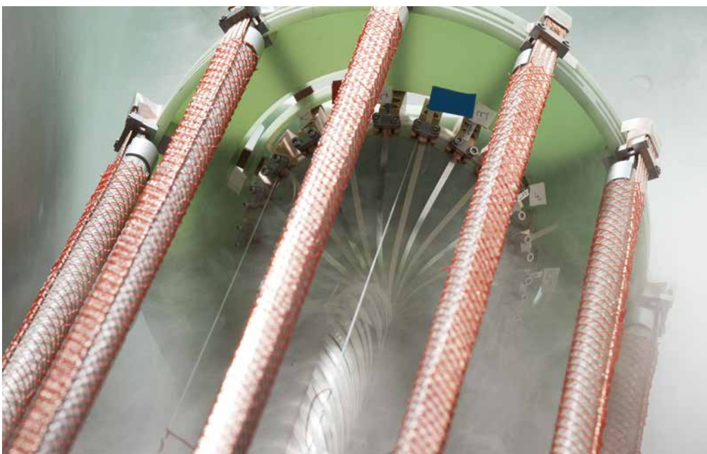
Supraleitende Kabel können Strom verlustfrei transportieren. Erstmals wird in der Stadt Essen ein supraleitendes Kabel im innerstädtischen Netz eingesetzt
